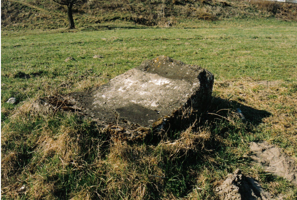
Fragment betonowego mostu wysadzonego przez Niemców
